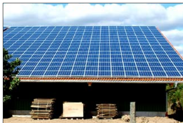
Fotonaponska elektrana u Njemačkoj, maks. snaga: 300 kW
