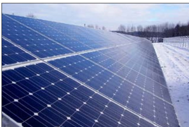
Fotonaponska elektrana u Njemačkoj, maks. snaga: 320 kW
